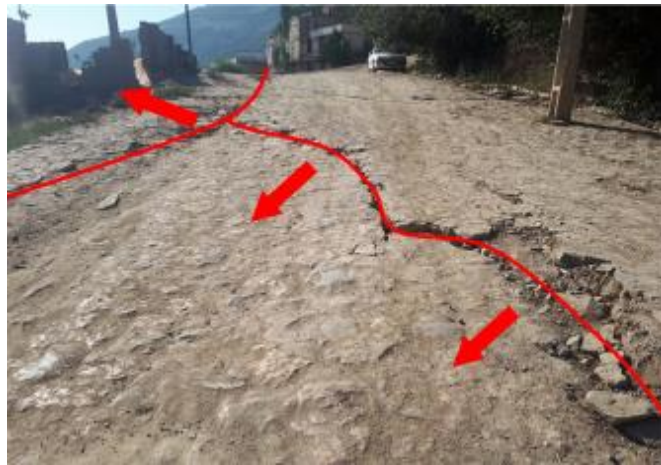
شکل ۳۱: تخریب و گسیختگی سنگ فرش خیابان در منطقه رانشی
