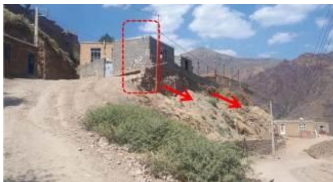
شکل ۲۳: در برخی نواحی اختلاف تراز در دامنه‌ها و شیروانی‌های ایجاد شده از یک سو و نامناسب بودن مصالح از سوی دیگر باعث ایجاد خسارت به بناها می‌شود. عمده مصالح بکار رفته در بناهای روستای کفچرین سنگچین و آجر است.
