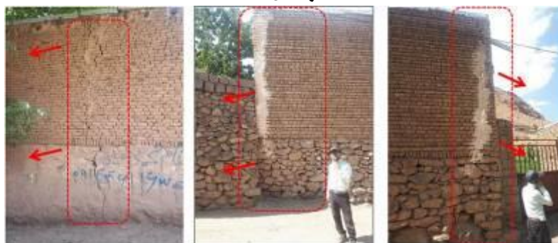
شکل ۱۵: آثار حرکت زمین لغزش در منطقه ۴ در شکل ۱۱، جهت و مکانیزم حرکت منطبق بر زمین لغزش اصلی و قدیمی است. به علت نبود پی مسلح و صلب با جابجایی آن، دیوارهای آجری و سنگی دچار شکست برشی شدند.
