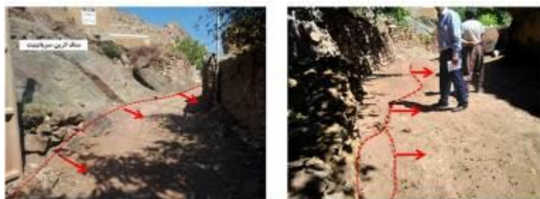
شکل ۱۳: ترکهای کششی ایجاد شده در منطقه ۳ شکل ۱۱، این ناحیه بالاترین حد ایجاد ترکهای کششی است و منطق بر سطح گسیختگی زمین لغزش قدیمی است و سطح گسیختگی حد فاصل بین سنگ بستر و خاک روی آن است.
