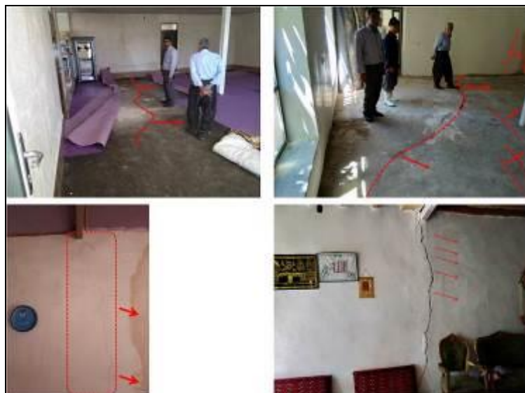
شکل ۱۸: آثار حرکت زمین لغزش در منطقه ۵ در شکل ۱۱، زیرسازی ضعیف و نداشتن یک پی صلب و مسلح باعث شده تا با حرکت خاک پی گسیختگی در کف اتاق ها و دیوارها بوجود آید. در دو شکل پایین شکست در زیر یک تیر نشان دهنده ضعف در باربری دیوارهای مصالح بنایی است.
