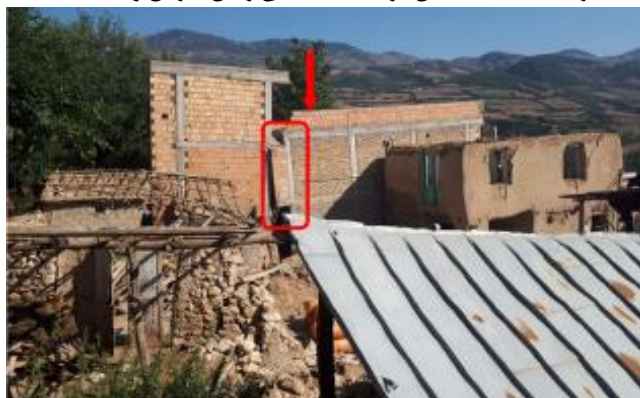
شکل ۳۰: دوران و واژگونی پی ساختمانهای با اسکلت بتنی در اثر حرکت زمین. کج شدگی ساختمان به سمت بالادست کاملاً دیده می شود (جهت حرکت از سمت چپ به راست است)
