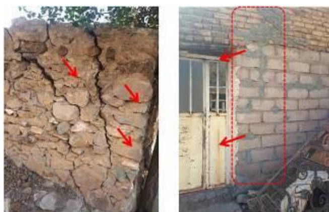
شکل ۱۴: شکست در دیوارهای با مصالح بنایی، حرکت پی باعث ایجاد تنش کششی در دیوارهای ضعیف شد، منطقه ۳ در شکل ۱۱
