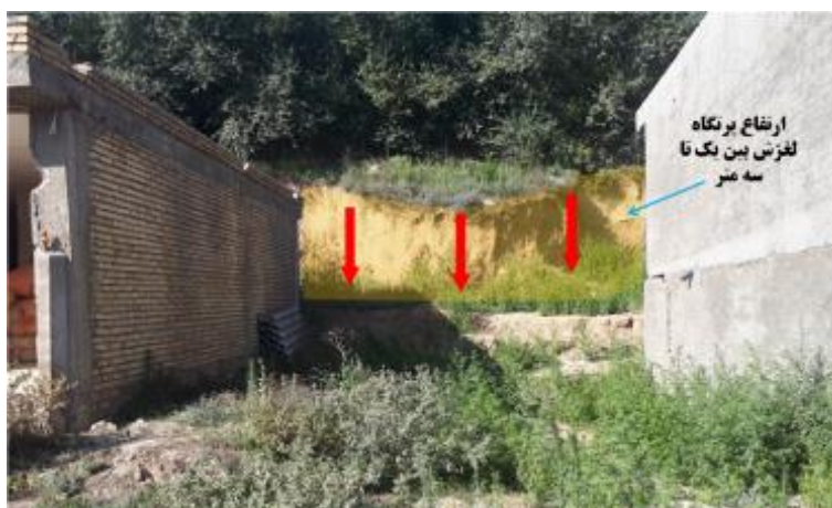
شکل ۲۸: پرتگاه لغزشی تقریباً قائم که می تواند نشانه عمیق بودن سطح گسیختگی باشد. همچنین امتداد این پرتگاه بر سطح گسیختگی قدیمی استوار است (در حال حاضر به صورت یک باغ باریک در زیر یک کوچه قرار دارد)
