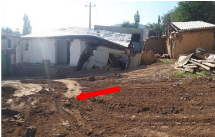
شکل ۲۹: تخریب کامل ساختمان در قسمت بالایی زمین لغزش و ایجاد شیب معکوس
